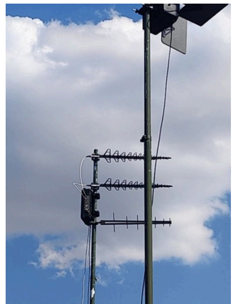
Sensorik am Mast: unauffällig, wartungsarm, aus der Ferne betreut.
